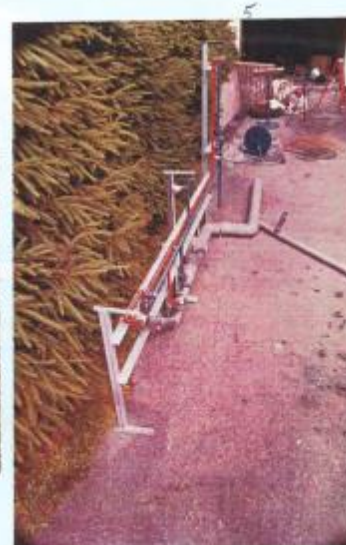
Bazen s mlaznicama ugrađenima u zid
